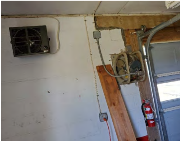
Unit Heater and Exhaust Fan
