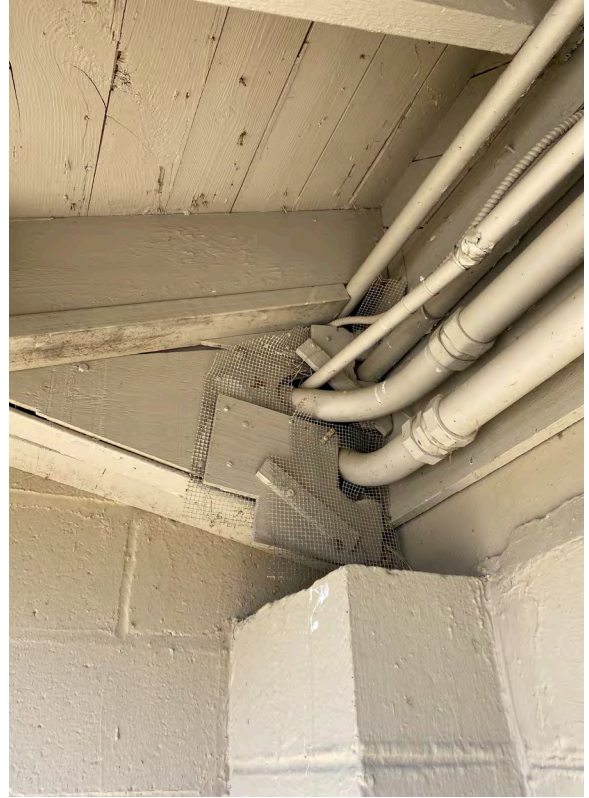
Room 411 - Elec Conduits
